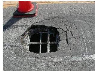
【道路が損傷した例】
